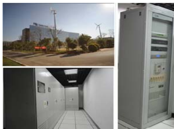
Figure 1. Micro-grid demonstration project 图 1. 微网示范工程
