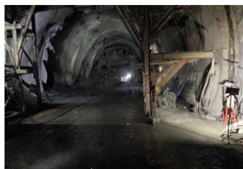
(b) 青海加西公路互助北山隧道塌方
