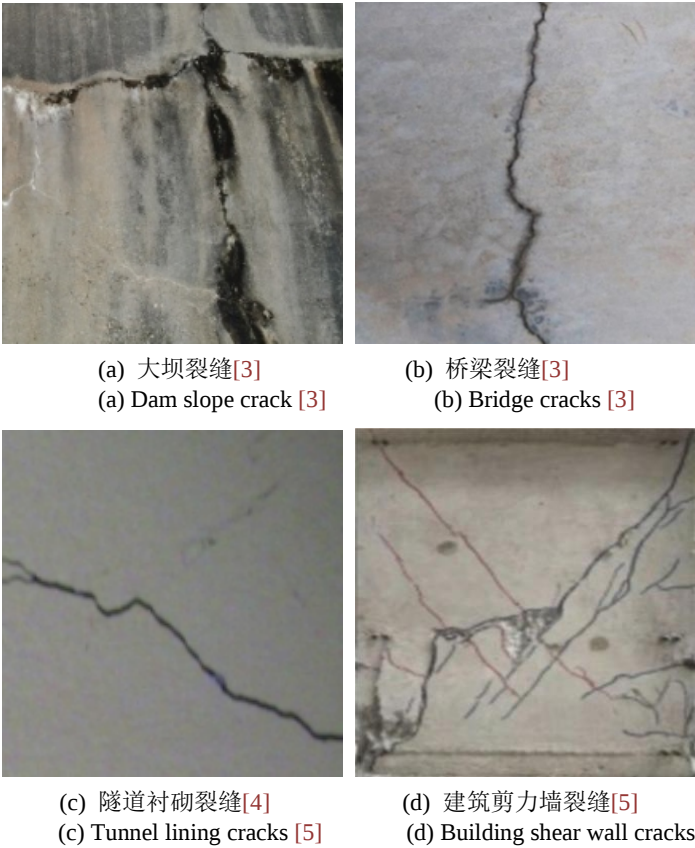
Figure 1. Crack picture 图 1. 裂缝图片
