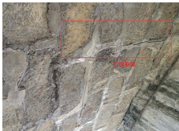
Figure 7. Wall cracking 图 7. 立墙开裂
