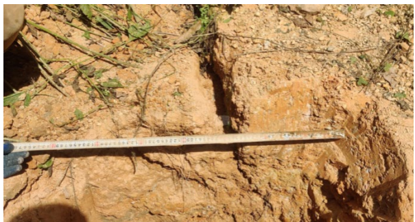
(b) XP1 滑坡隐患后缘裂缝宽度
