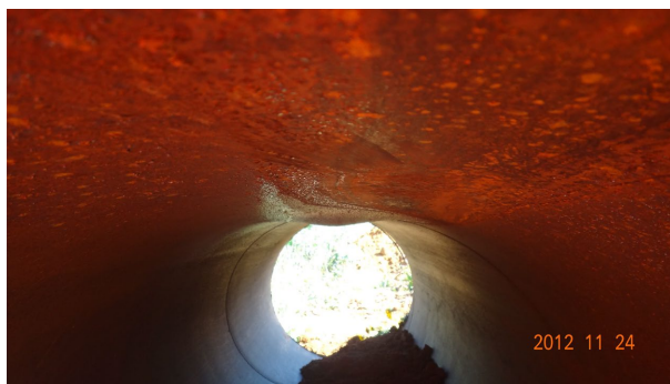
Figure 6. Internal protrusion of pipeline 图 6. 管道内部凸出
