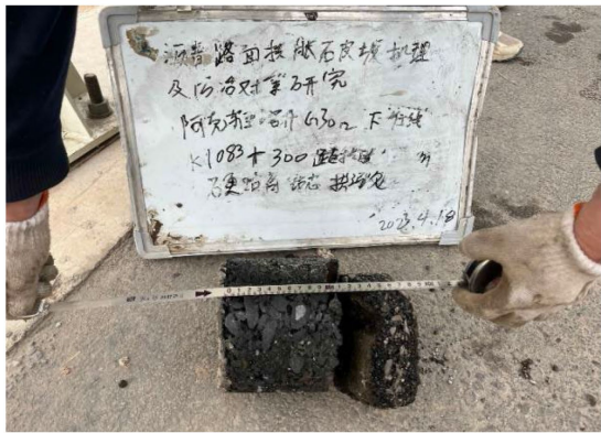
(a) 沥青面层芯样表面存在不均匀孔洞
